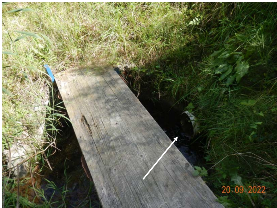
Messstelle Schacht 2 – Messstelle Wasser
